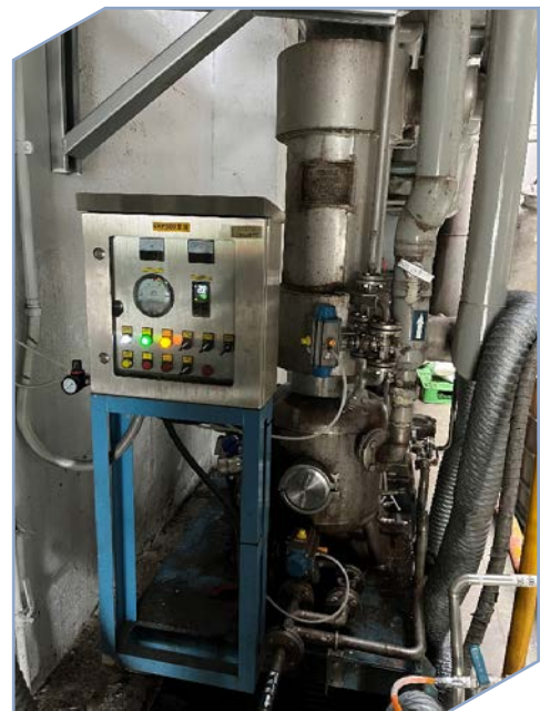
真空泵水回收系統
