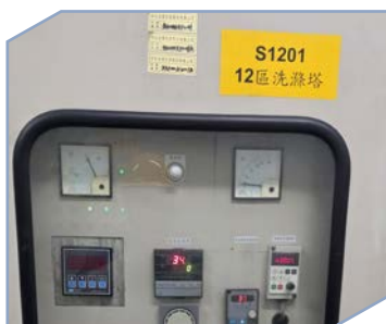
12 區 S1201-502 洗滌塔 30HP 排風機
