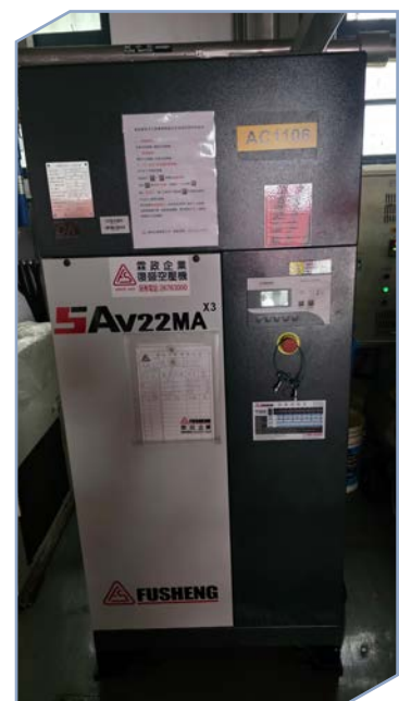
13 區 15HP 空壓機汰舊換新
